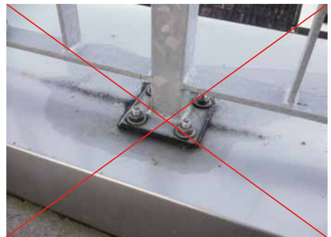
Abb. 7: Mangelhafte, unzulässige Ausführung
